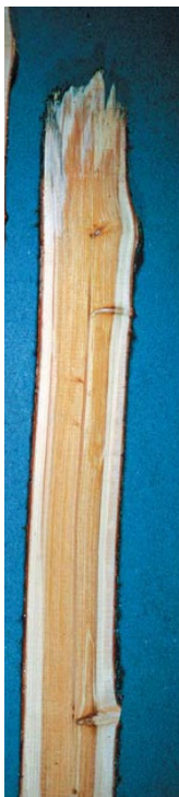
Råte fra toppbrekk forårsaket av snø.
