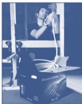
Elektro og kabelvern
